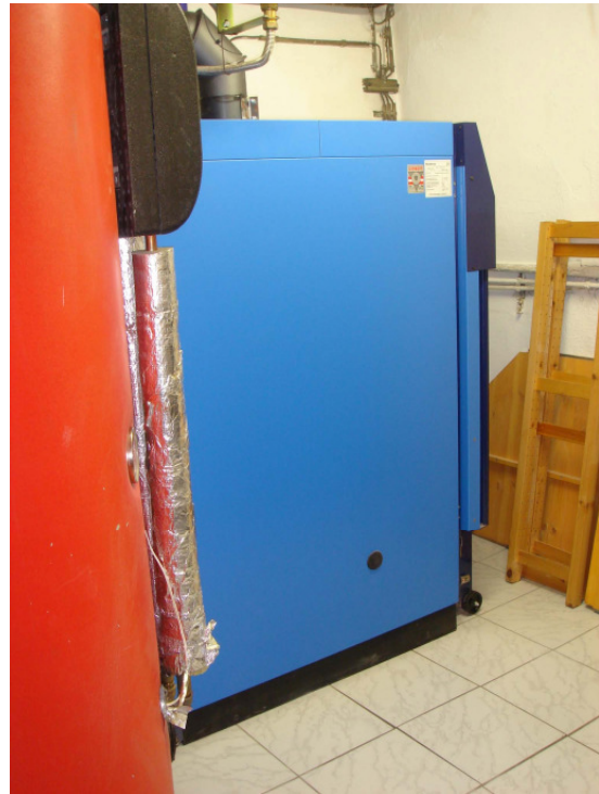
Abbildung 14: Pelletskessel neben Pufferspeicher
