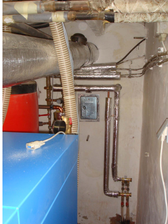
Abbildung 5: Anschluss des Pelletskessels an den Rauchzug (nachher)
