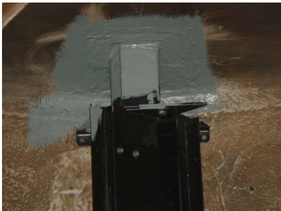
Abbildung 9: Detail des Anschlusses der Förderschnecke im Pelletsraum
