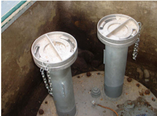
Abbildung 13: Pelletsbefüllanschluss auf ehem. Tankdeckeldom
