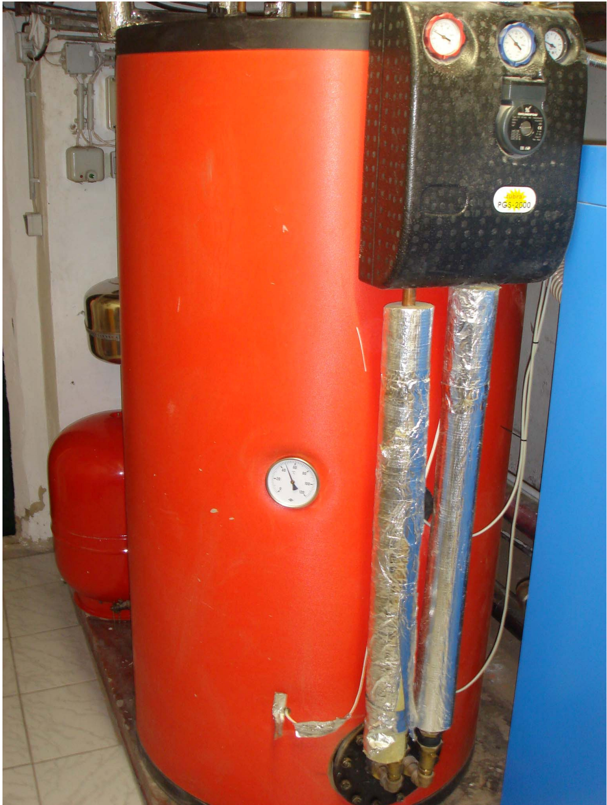
Abbildung 3: Pufferspeicher mit Solarbeschickung
